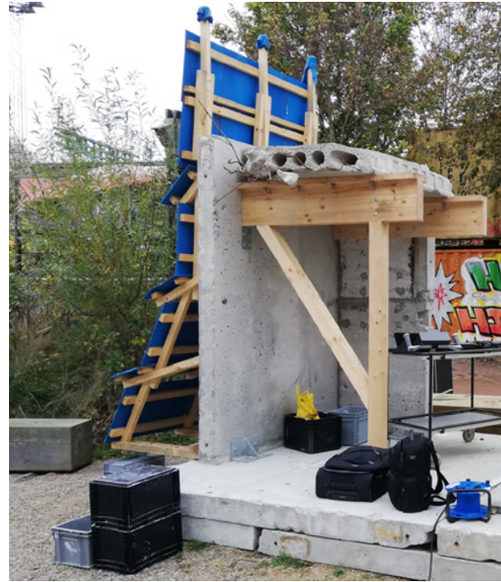
Fig. 11: Mock-up-konstruktionen bygget af genbrugte bærende betonelementer. / The mock-up structure built using reclaimed structural concrete elements.
