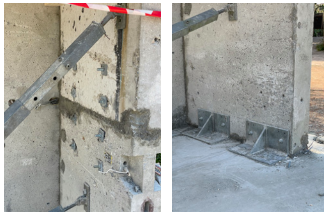
Fig 11-12: Rå samlinger og eksponerede beslag og sammenhæftninger. / Rough joints and exposed brackets and stichings.
